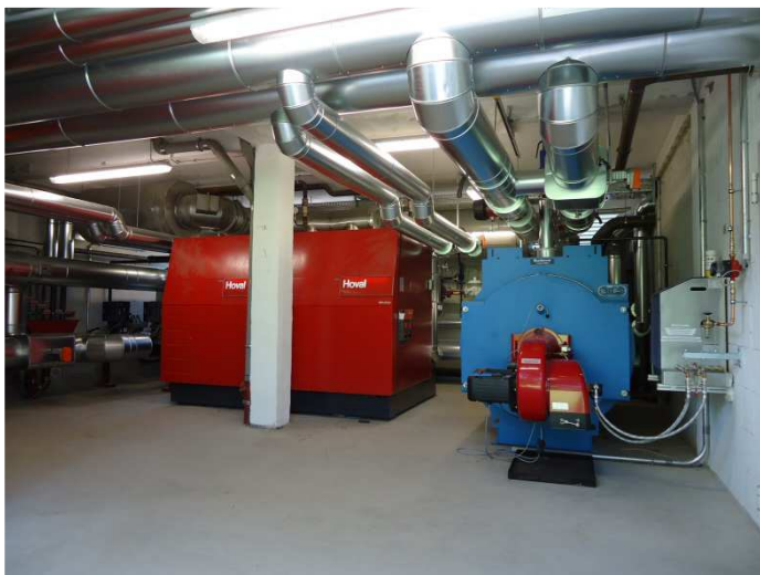
Brennwertkessel Erdgas Fabrikat Hoval, 2 x 750 kW NT-Kessel Heizöl Fabrikat Buderus 1.700 kW
