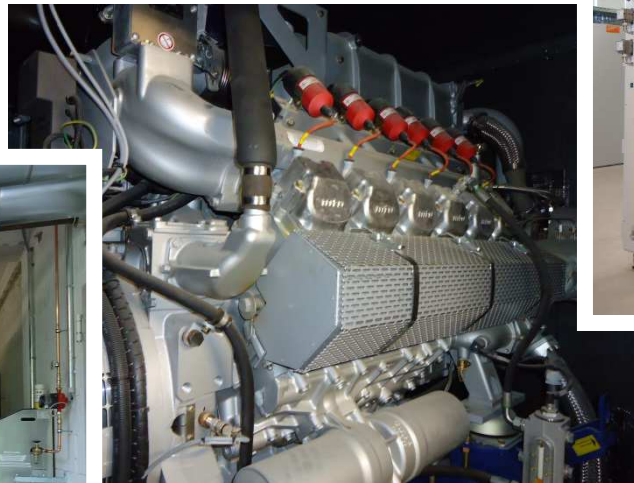
Blockheizkraftwerk Fabrikat MTU 535 kWth, 420 kWel
