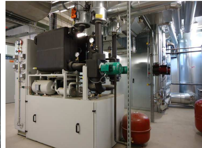
Elektrische Wärmepumpe Fabrikat Combitherm 220 kWth, - 56 kWel
