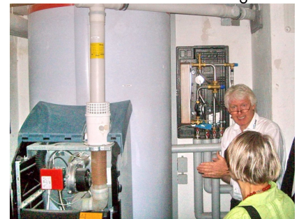
Pufferspeicher mit integriertem Brennwertgerät (li.) und Trinkwasserstation (hinten re.), beide geöffnet bei Führung in 2010 mit Joachim Kreuz anl. Samstags-Forum/ECOtrinoa e.V.
