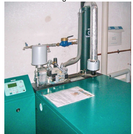
Das Mini-BHKW mit Kontroll-Konsole links, Wärmetauscher f. Brennwertnutzung rechts
