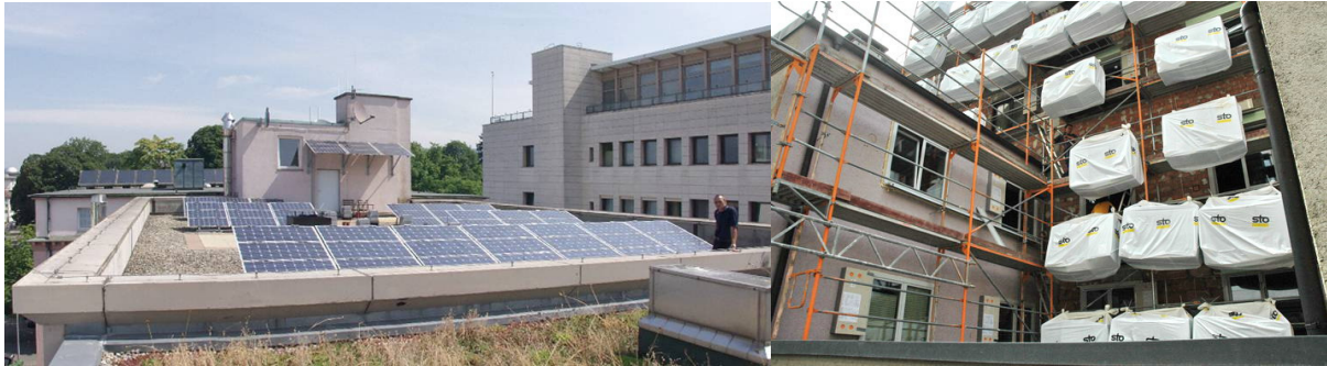
Solargeneratoren und -Kollektoren auf dem Dach. Umbau (Hinterhaus) zum Passivhaus-Standard. Abb.: Hotel Victoria
