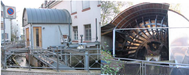
EM: Turbine EEE am Stadttor (li), Wasserrad EEE, Romaneistraße
